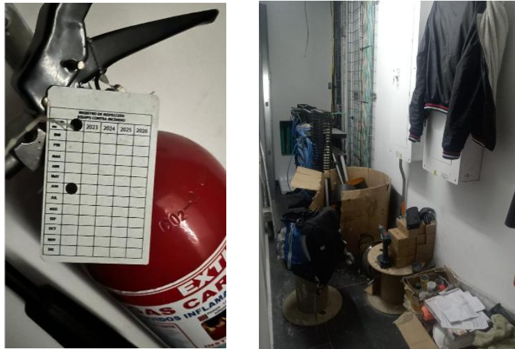
Imagen 31. Piso 4. Cuartos técnicos.
